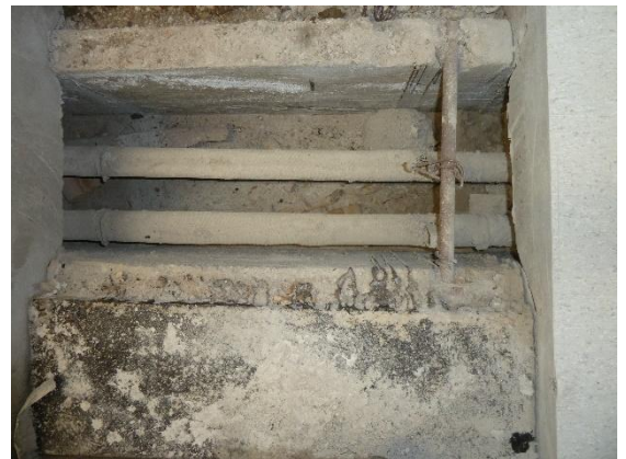
Kuva 3. Vanhat putkieristeet sisältävät asbestia. Asbestipitoisia materiaaleja on useita erilaisia. Huonokuntoiset putkieristeet sekä kanaalin pohjalla olevat irtoneiset eristeenpalat aiheuttavat riskin asbestikuitujen irtoamisesta sisäilmaan.
